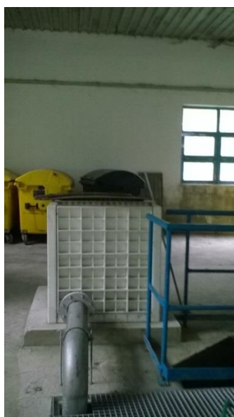
OBRÁZEK 5 : JÍMKA NA DOVÁŽENÉ ODPADNÍ VODY
