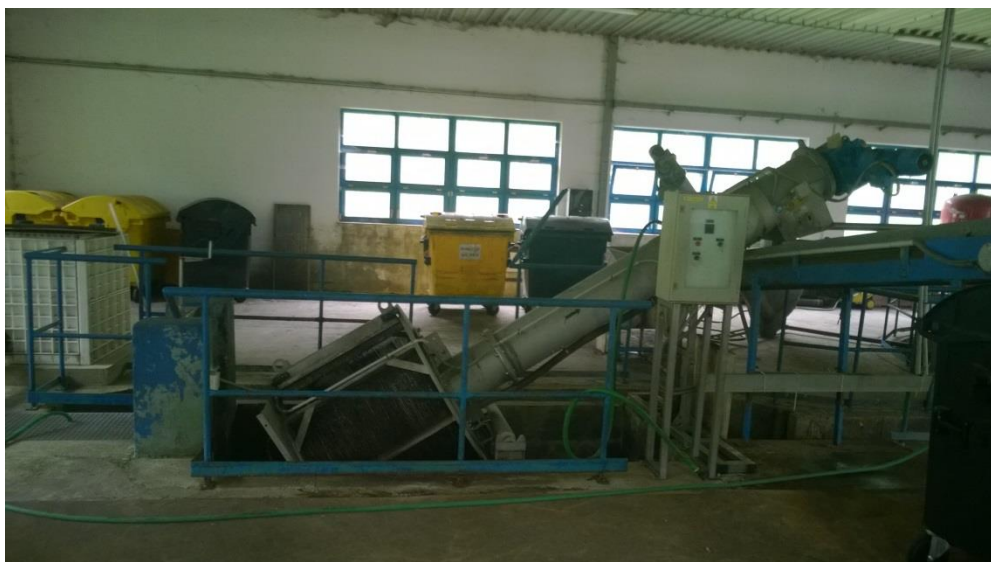
OBRÁZEK 4 : STROJNÍ ČESLE NA NÁTOKU NA ČOV
