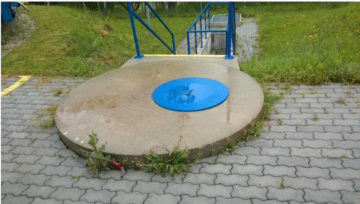
OBRÁZEK 13 : MĚRNÝ OBJEKT VYČIŠTĚNÝCH VOD A PROPOJOVACÍ ŠACHTA
